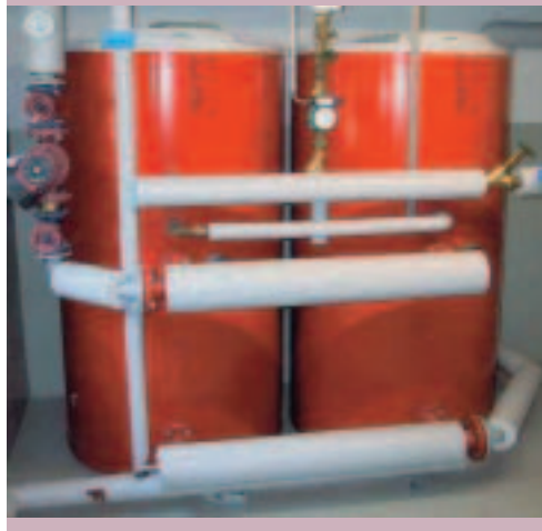
Bild 28: Warmwasserspeicher für zentrale Warmwasser- erzeugung (Quelle: EStW)
