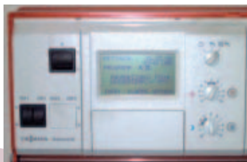
Bild 26: Moderne Heizungsregelung (Quelle: EStW)
