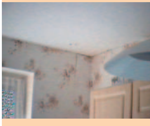
Bild 21: Schimmelflecken an der Küchenwand (Quelle: Protherm)
