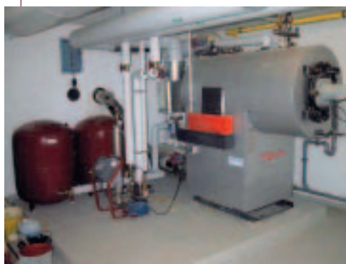
Bild 23: Gasbrennwertkesselanlage (Quelle: EstW)
