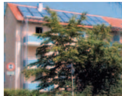
Bild 30: Solarthermieanlage mit 50 m 2 Fläche auf einem Mehrfamilienhaus, GEWOBAU Erlangen
